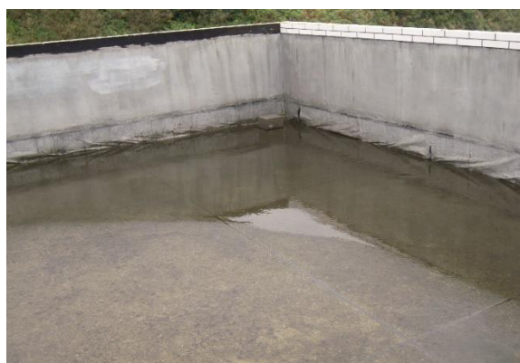
屋頂破損積水
