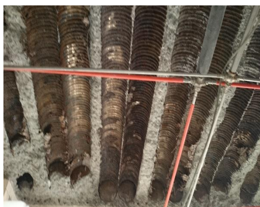
A 側 4 樓浴室天花板
