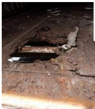
貨櫃破損情 況 & 維修 貨櫃的地方
